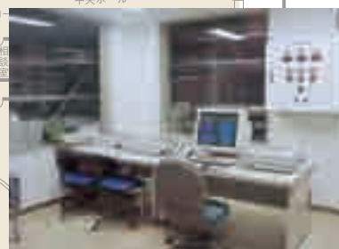
ボイラー監視室
